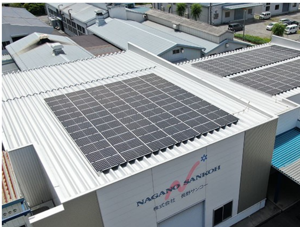
弊社やなぎ通り工場の屋根に設置された太陽光パネル
